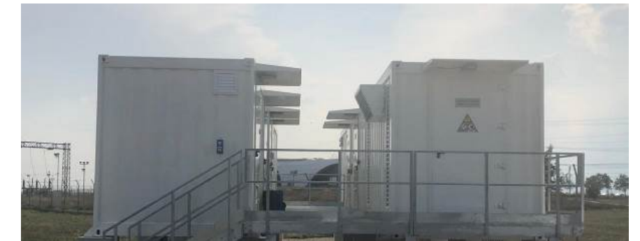
Figura 31: Esempio di installazione sistema BESS in impianto
