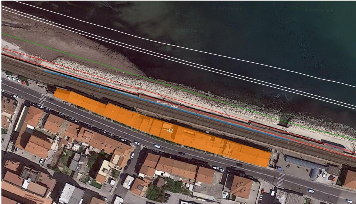
Figura 9: esempio di posa in opera di barriere acustiche provvisorie a protezione dei Ricettori tipo R2
