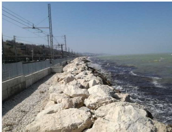
Figura 2 - Scogliera radente che costeggia il rilevato ferroviario
