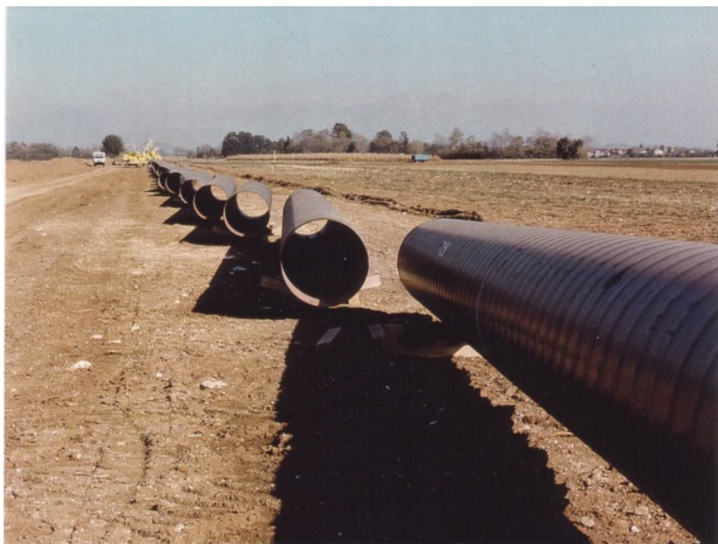
Foto 3.D: Esempio di sfilamento tubazioni
