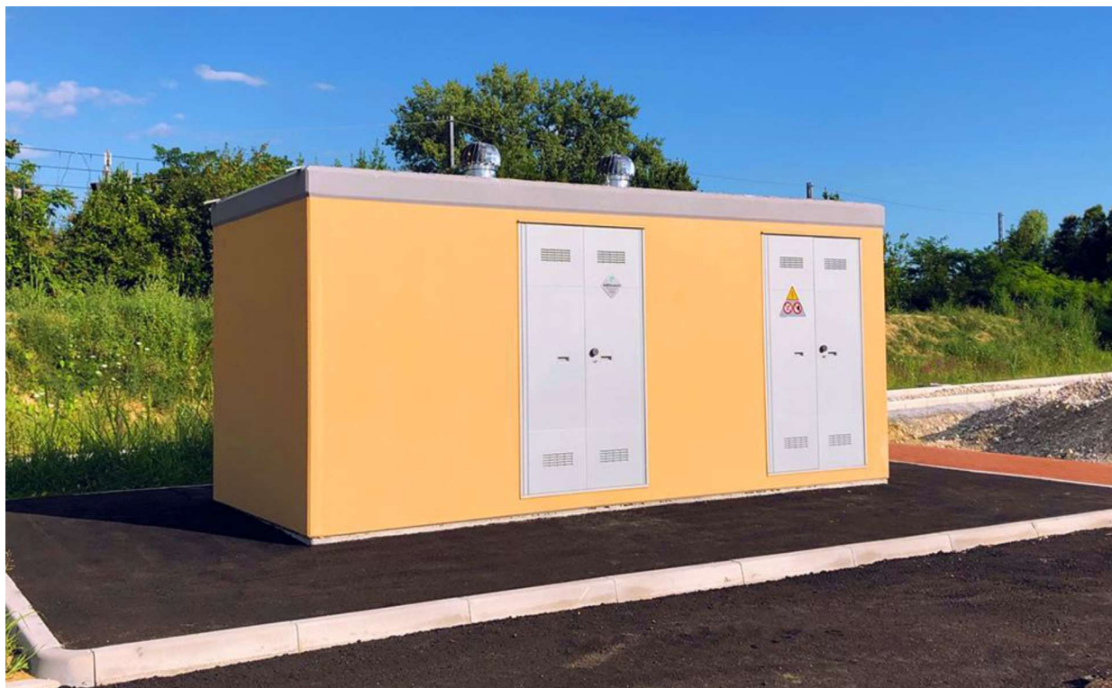
Fig. 23 : esempio di cabina standard enel
