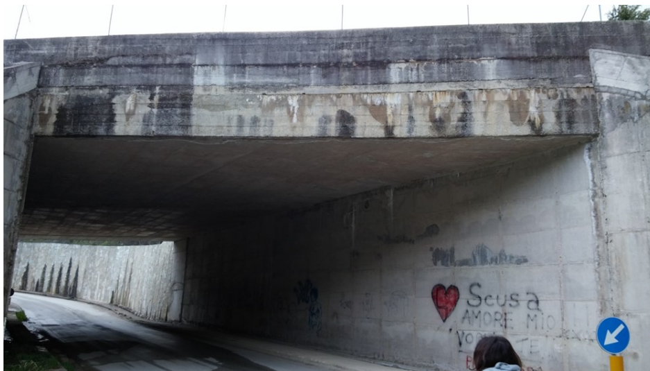
Foto 32 - Sottovia scatolare comunale
