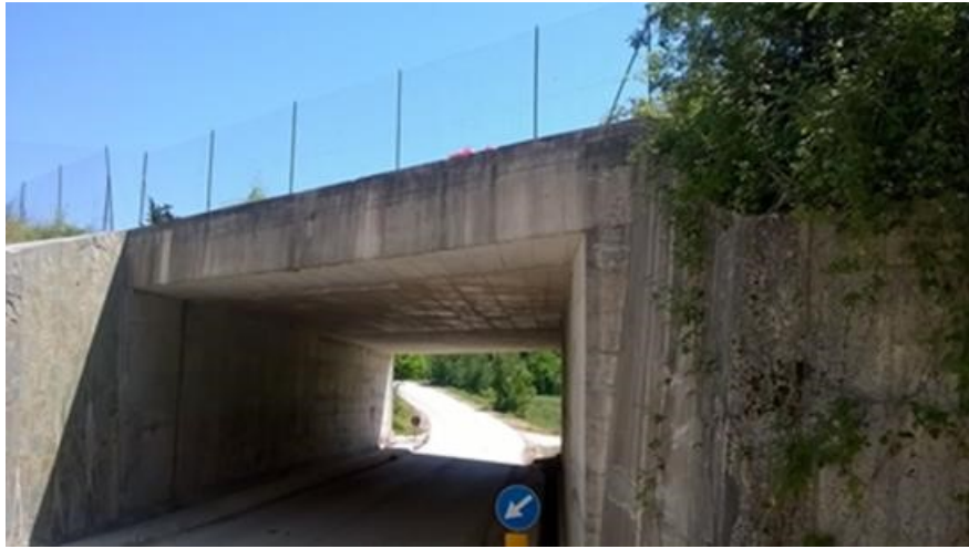
Foto 31 - Sottovia scatolare comunale
