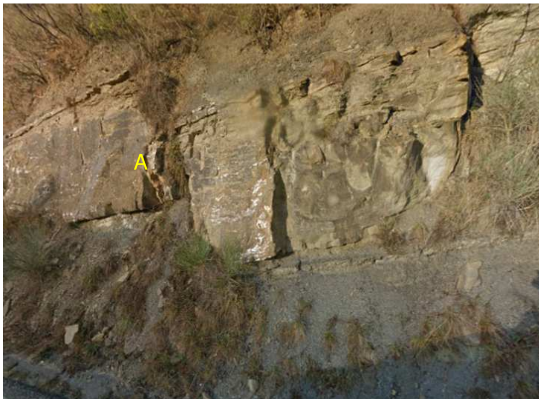
Fig. 14: Lungo la strada SP 200 nei pressi dell'imbocco della galleria lato-Umbria: Piccola faglia (A) che sblocca il regolare andamento degli strati di Marnoso-Arenacea immergenti a W-SW (250°)
