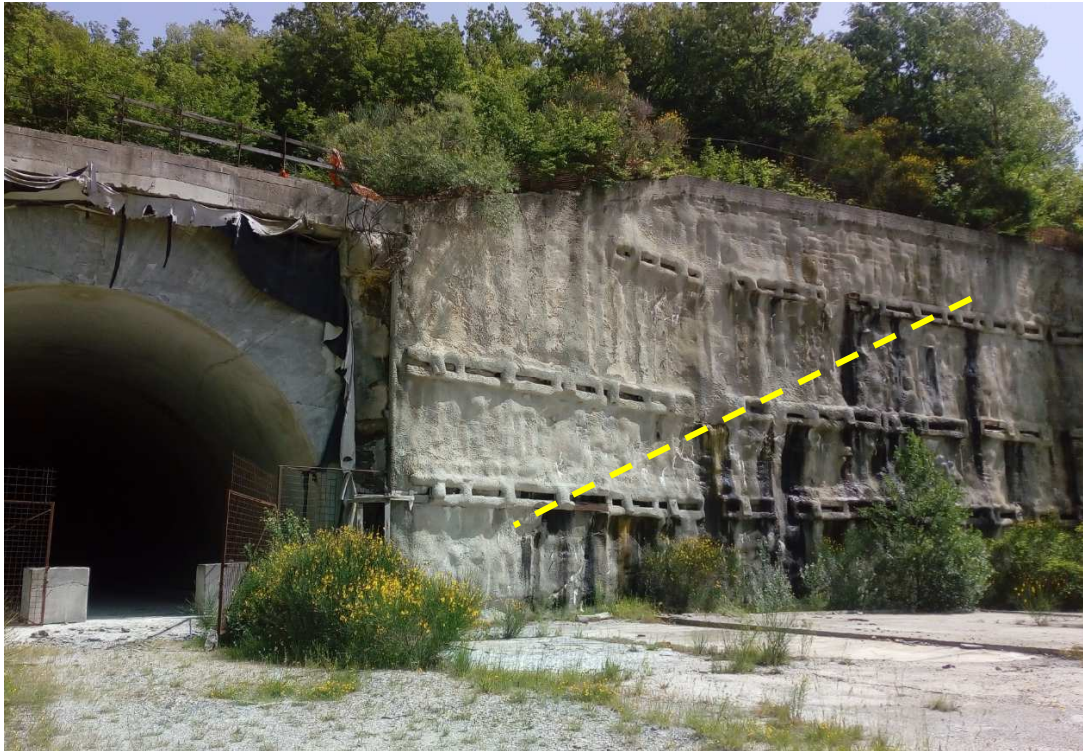
Fig. 43: Imbocco della galleria Guinza lato-Umbria, con la paratia di micropali tirantati attraverso cui è visibile l'afflusso idrico permanente (o semi-permanente). A meno del "disturbo idrogeologico" ed effetto drenante indotto dagli scavi e dalle fessurazioni secondarie, i punti di afflusso sembrano allineati all'incirca lungo l'immersione (linea gialla tratteggiata, componente lungo la paratia) della stratificazione della Marnoso-Arenacea.
