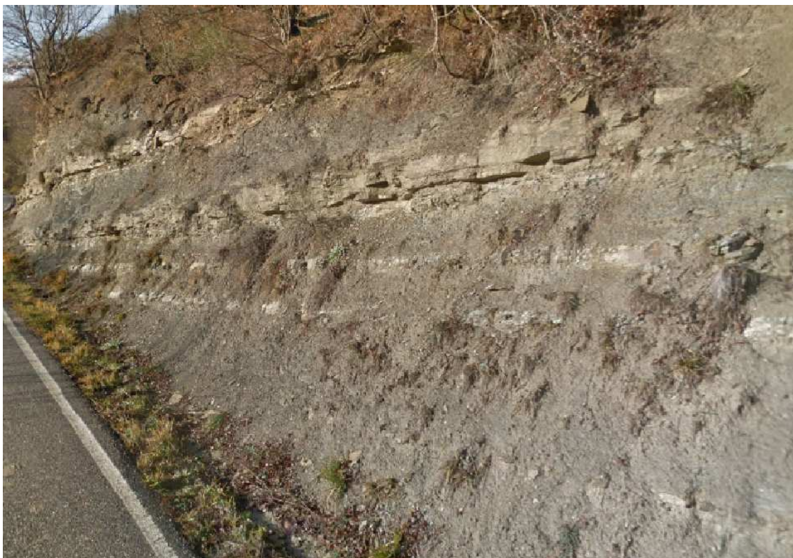
Fig. 7: Affioramento della Formazione Marnoso-Arenacea (Membro FMA4a) lungo la SP 200, nei pressi di Parnacciano. Prevalenza di strati pelitici (rapporto A/P circa 1:2 nella parte alta, e 1/6 nella parte bassa).
