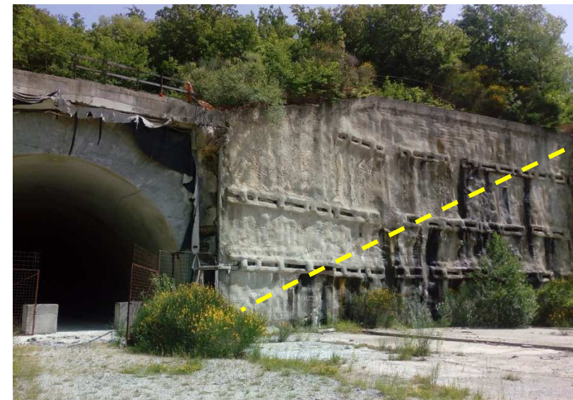
Figura 9 – Stillicidio attraverso la paratia di imbocco della Galleria Guinza lato Umbria
