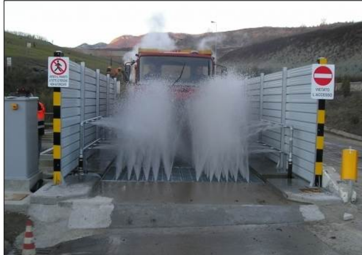
Impianto lavaggio ruote
