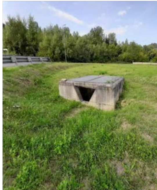
Figura 229 - Tratto tombato in corrispondenza della rotatoria davanti Caserma VV.FF. – Pozzetto ispezionabile
