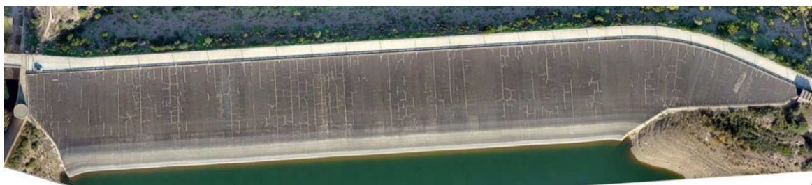
Figura 5.2.1: Diga di Medau, stato fessurativo
