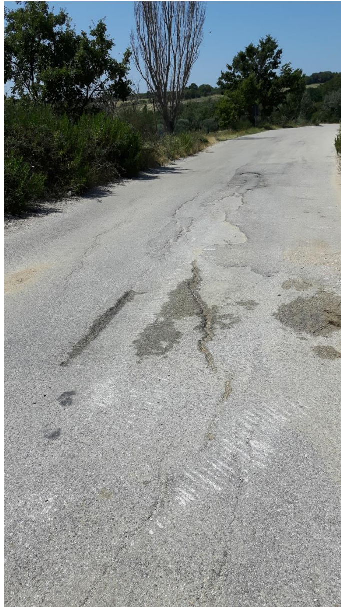
Figura 29. Lesioni ed avvallamenti sulla carreggiata stradale in corrispondenza della pista di accesso alla WTG08.
