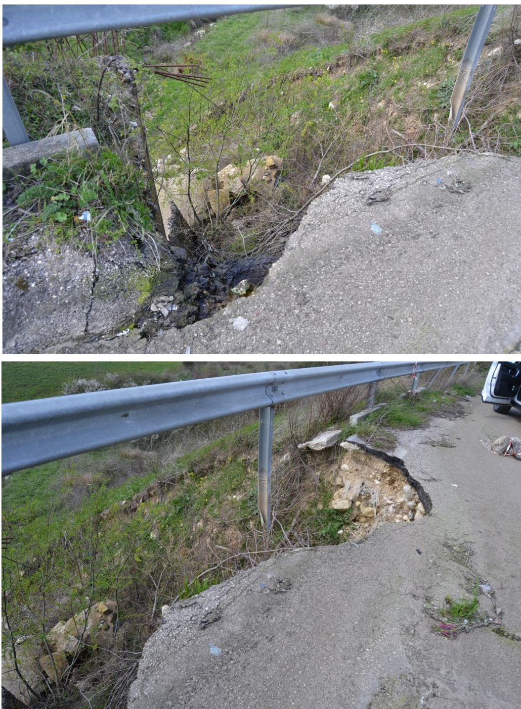
Figura 28. Forme di scalzamento per erosione regressiva al margine della strada comunale vicino l'area di sedime della WTG 05
