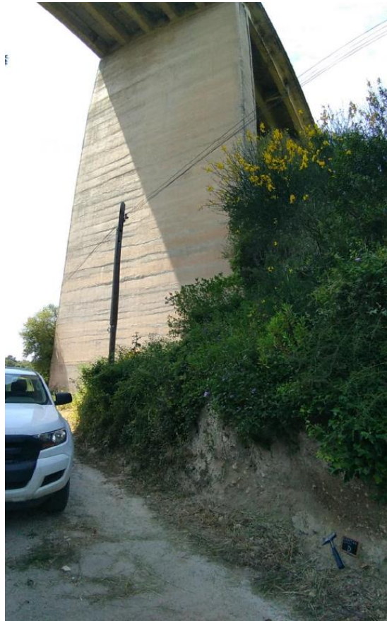
Depositi di versante al disotto del viadotto sul Rio Giuncheddu (Scheda di rilevamento 4)
