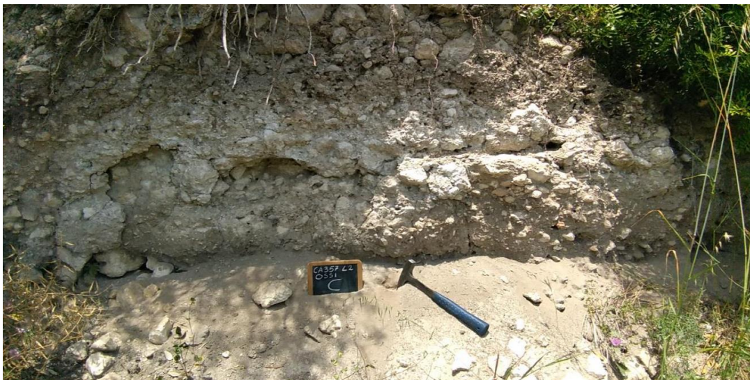
Affioramento breccie cementate osservate durante la campagna di rilevamento nel tratto stradale compreso le due gallerie in progetto (Vedi scheda rilievo geologico 3)
