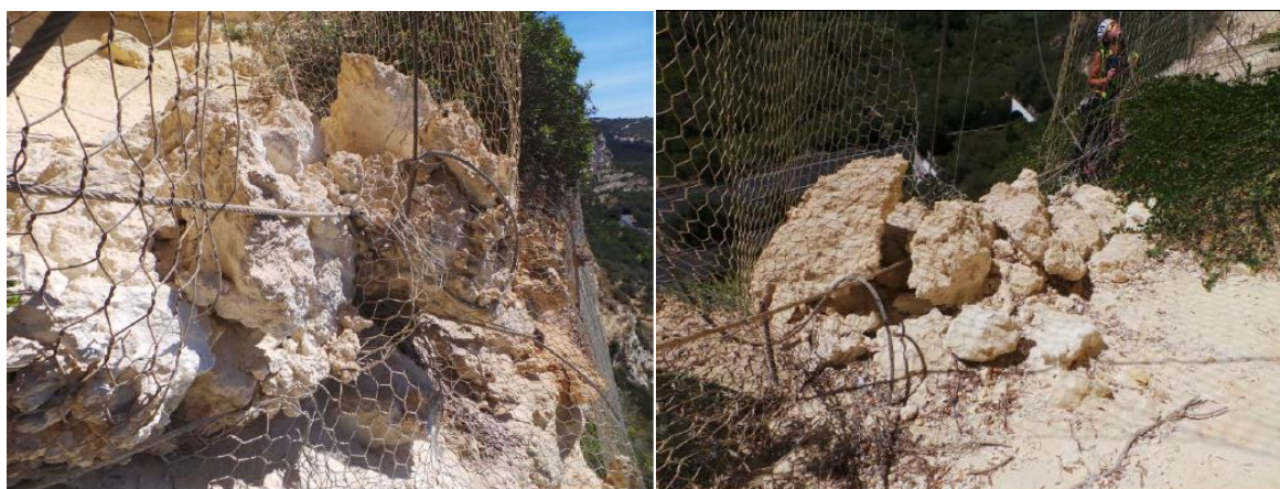
Figura 4.2: Accumulo di crollo posto alla base della parete lato destro – Diedro 1
