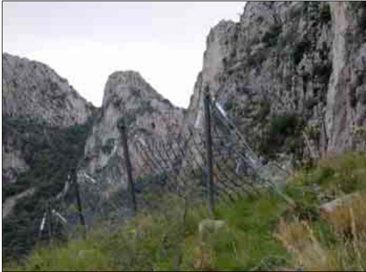
Figura 40: Barriera paramassi elastica ad alto assorbimento di energia tradizionale.
