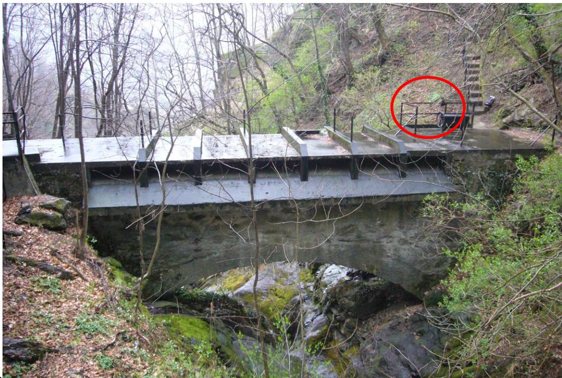
Ponte canale sulla Val di Roggio. Vista dello sfioratore laterale, in evidenza l'organo di manovra della paratoia dissabbiatrice.
