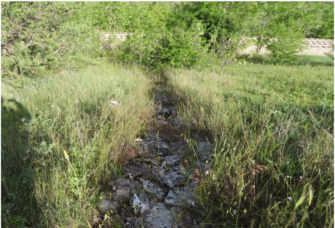
Figura 9-5 Foto in corrispondenza di una delle trincee drenanti realizzate in pietrame calcareo. La foto è stata scattata da sopra il versante verso il basso dove corre la linea ferroviaria.
