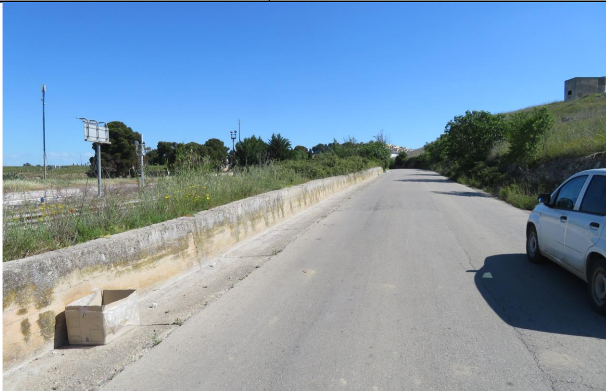
Figura 10-13.1 Panoramica dell'areale di progetto nel pressi della Stazione di Canosa di Puglia. A destra muro di sostegno sulle calcareniti di Gravina. A sinistra muretto basso per proteggere la ferrovia dalle acque e dai detriti.
