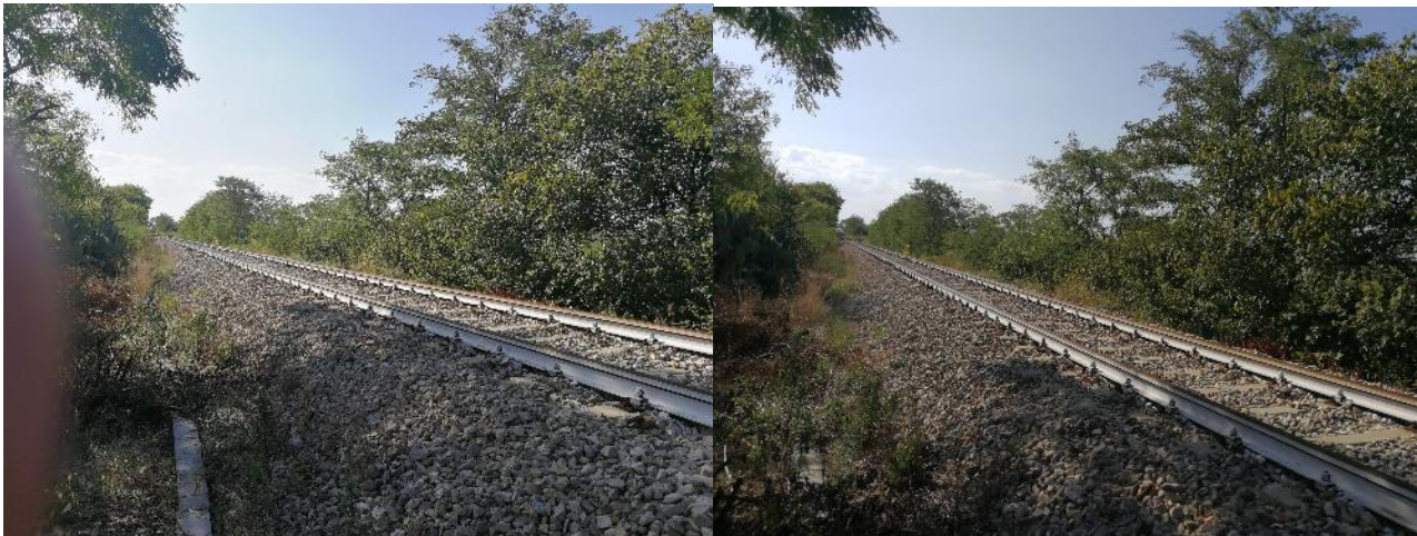
Figura 9-3 Foto scattate alla pk 10+300 dove si registra l'abbassamento del ballast.
