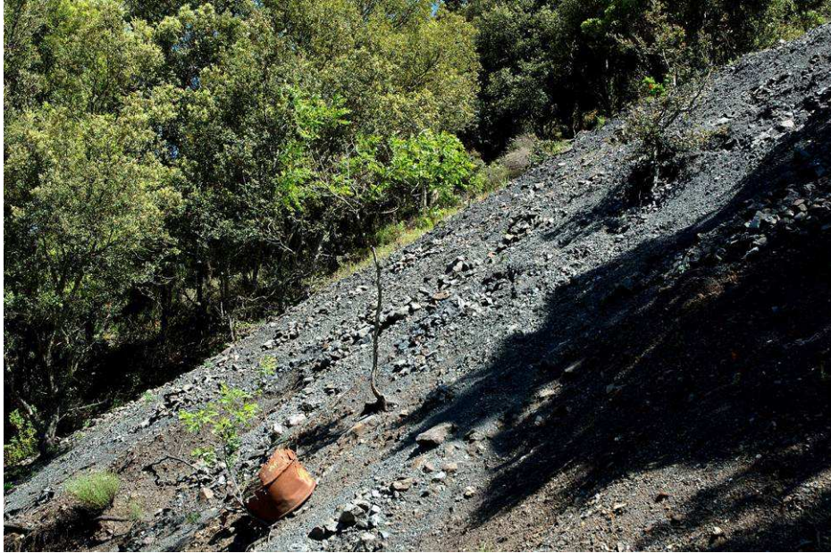
Foto 11. L'opera di ripristino attuata sulle discariche della riva destra del Rio Saraxinus non ha dato i risultati attesi. In questo caso sembra non siano state adottate misure adeguate alla situazione di forte acclività. Da un alto, infatti, mancano idonee strutture di contenimento, dall'altro sono state utilizzate essenze alloctone come Robinia pseudoacacia , che possiede scarse capacità di frenare i processi erosivi.
