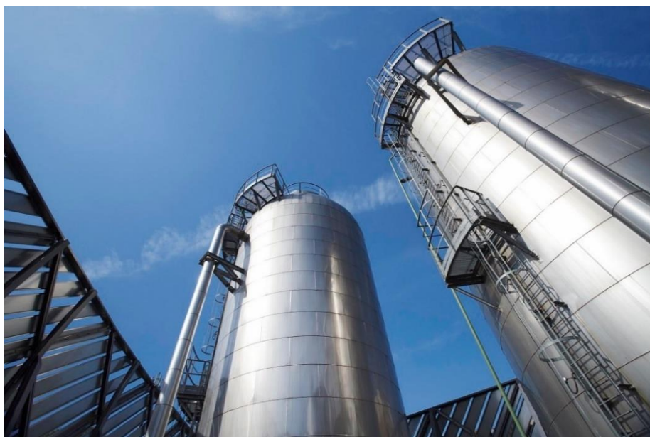
Figura 6.4: Accumulatori di Calore (Sito web: https://www.gruppoinren.it )
