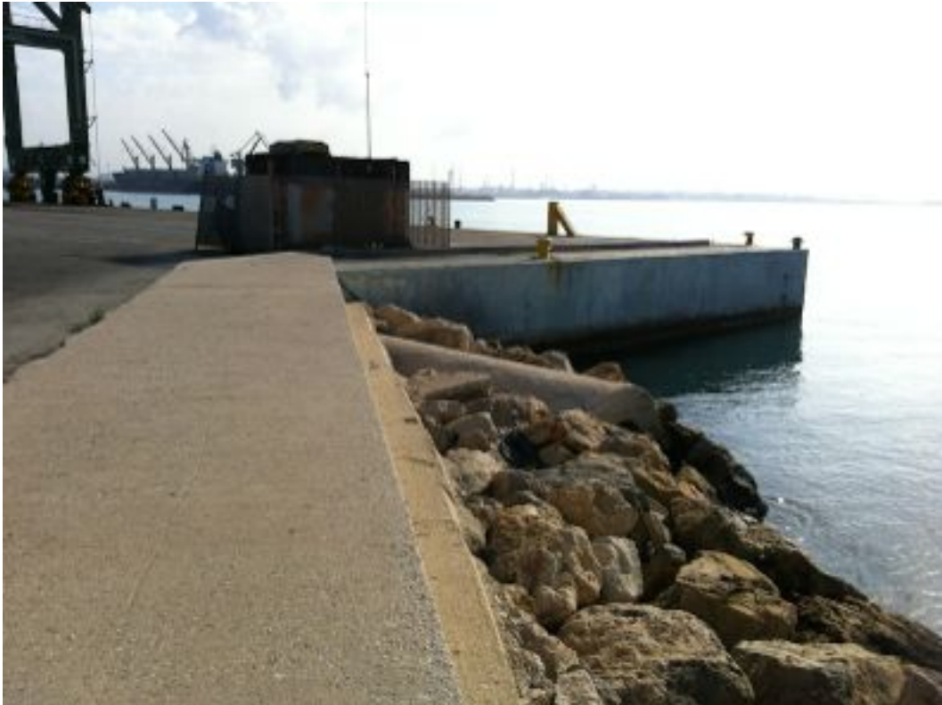
Foto 13. Porzione terminale secondo canale di scarico acque prima pioggia del molo, dir. fot. NE
