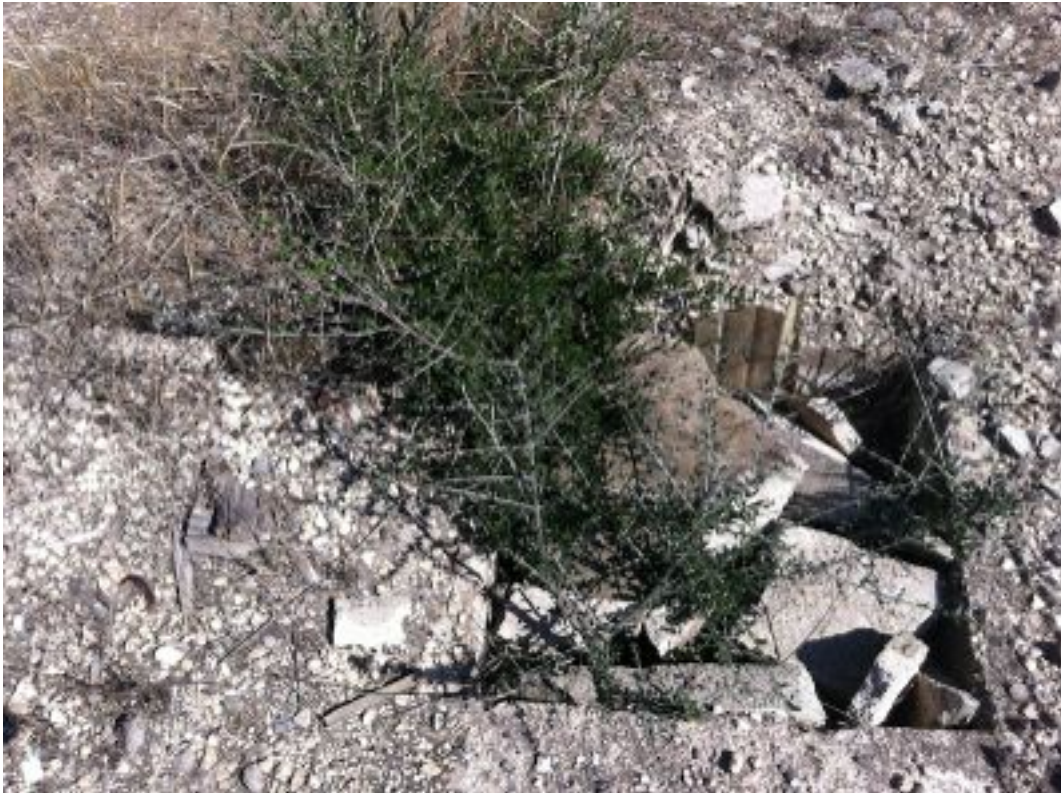
Foto 19. Particolare area di scarico acque dei piazzali con crescita spontanea di vegetazione, dir. fotografica Nord
