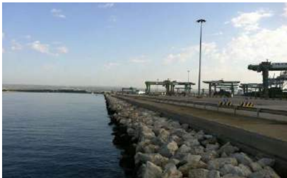
Figura 10.27 – Foto 9, Panoramica frangiflutti in pietra lato Nord molo polisettoriale, direzione fotografica NE.
