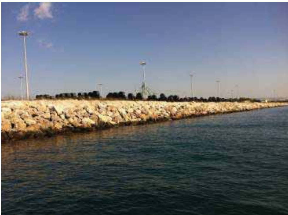
Foto 8. Particolare argine esterno scogliera frangiflutto testata 5° sporgente, dir. fotografica SE
