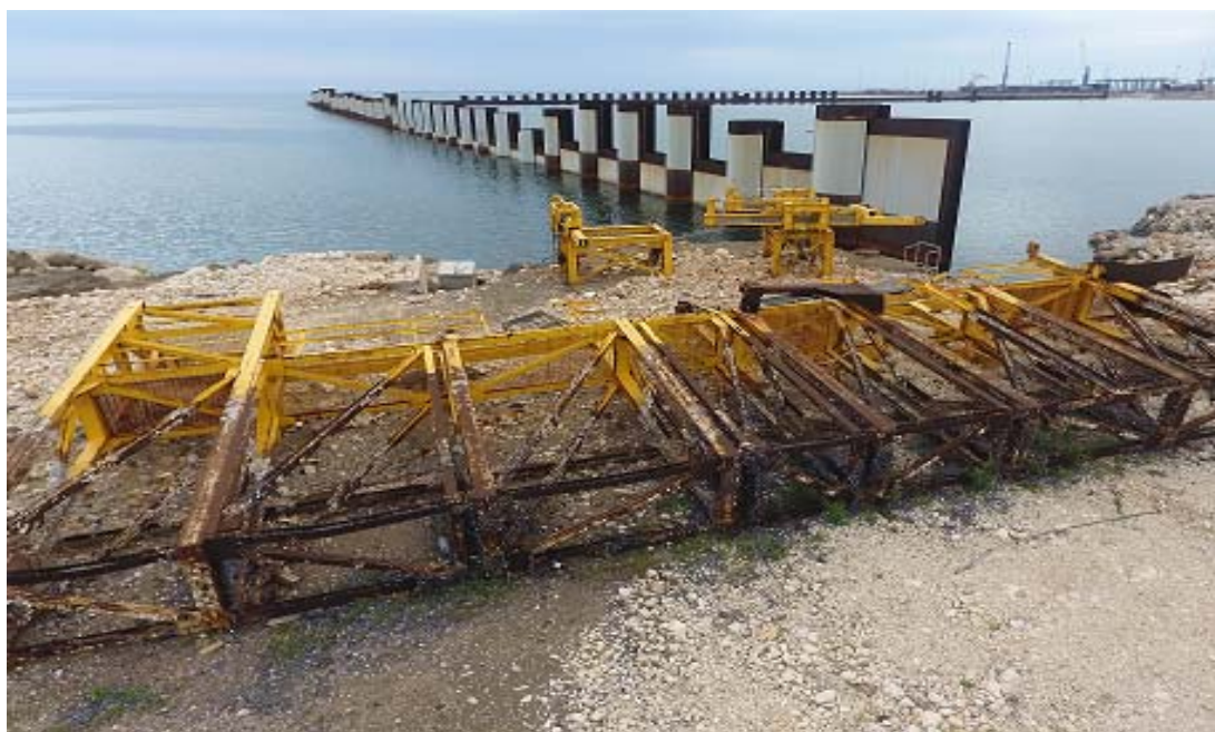
Fig. 4. Marginamento a mare _ Allineamento A-B e B-C (situazione pre 2019). Elementi parzialmente infissi non a quota di progetto.
