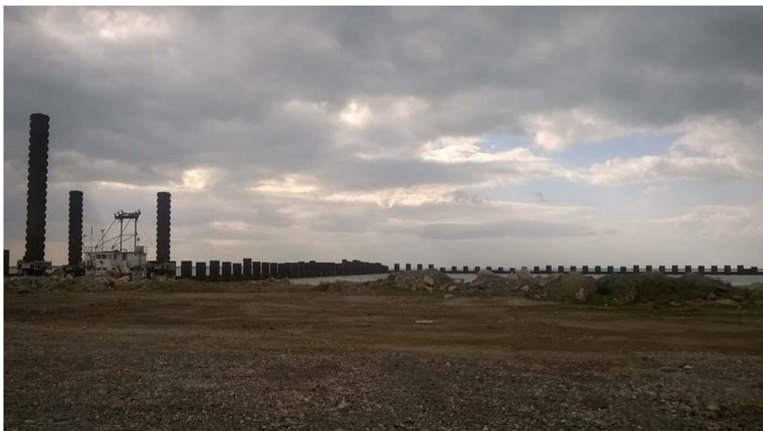
Fig. 3. Marginamento a mare _ Allineamento A-B e B-C (situazione pre 2019). Elementi parzialmente infissi non a quota di progetto.
