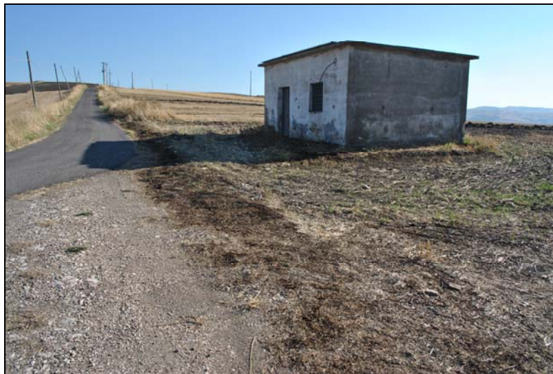
Figura 36: - Fabbricato esistente, in evidente stato di abbandono, da poter recuperare come cabina di raccolta.
