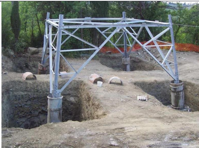
Figura 14 - Realizzazione di fondazioni superficiali tipo CR per un sostegno a traliccio. Nell'immagine si possono osservare le quattro buche, la base del sostegno collegata alla fondazione tramite i "monconi" ed i casseri utilizzati per i quattro colonnini (fonte: Terna spa)
