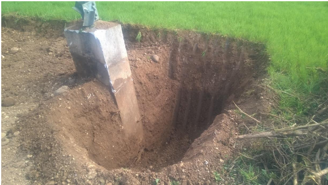
Figura 40 - Esempio rimozione della fondazione superficiale di un sostegno 380 kV ST (fonte: Terna spa)
