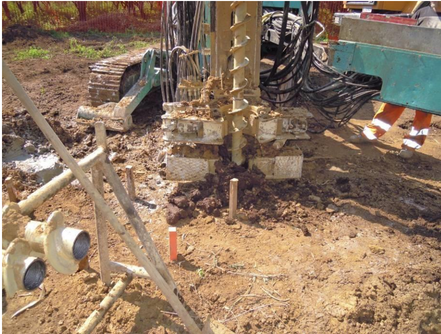
Figura 26 - Macchina operatrice per la realizzazione di micropali tubfix; sistema di scavo mediante trivella elicoidale (fonte: Terna spa)
