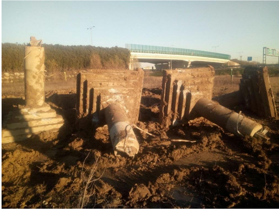
Figura 39 - Esempio di rimozione della fondazione superficiale di un sostegno 220 kV (fonte: Terna spa)
