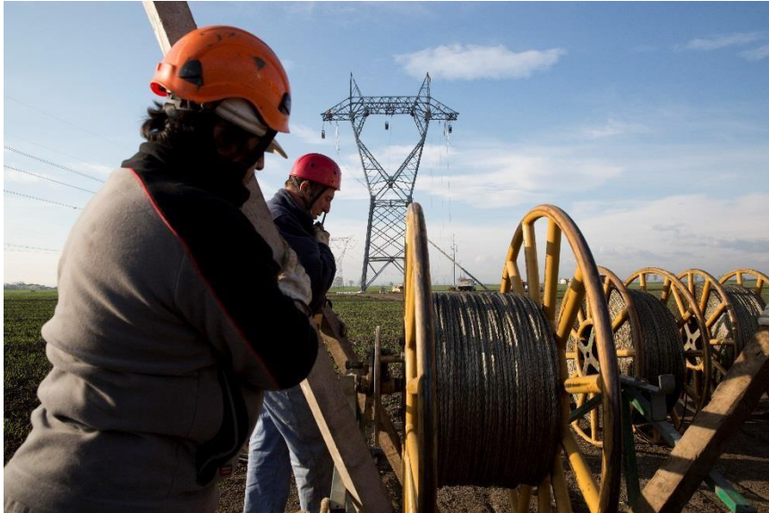
Figura 35 - Utilizzo dell'elicottero per la stesura della fune pilota. Si noti il particolare delle carrucole (fonte: Terna spa)
