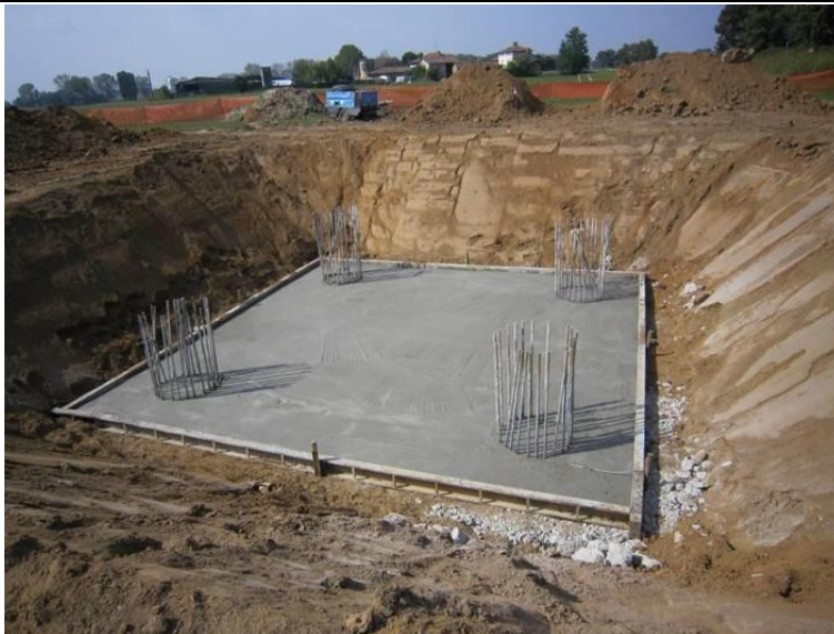
Figura 2.4 Esempio di realizzazione di fondazione profonda su pali trivellati per un sostegno monostelo
