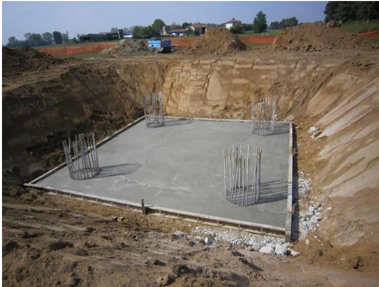
Figura 3.16 Esempio di realizzazione di fondazione profonda su pali trivellati per un sostegno monostelo
