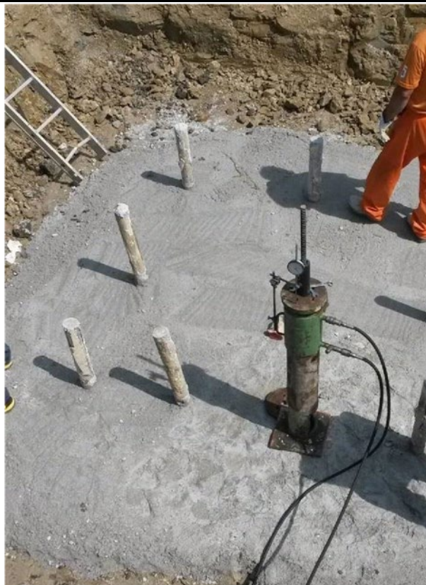
Figura 3.17 Esempio di realizzazione di fondazione profonda su micropali tipo tubfix per un sostegno a traliccio
