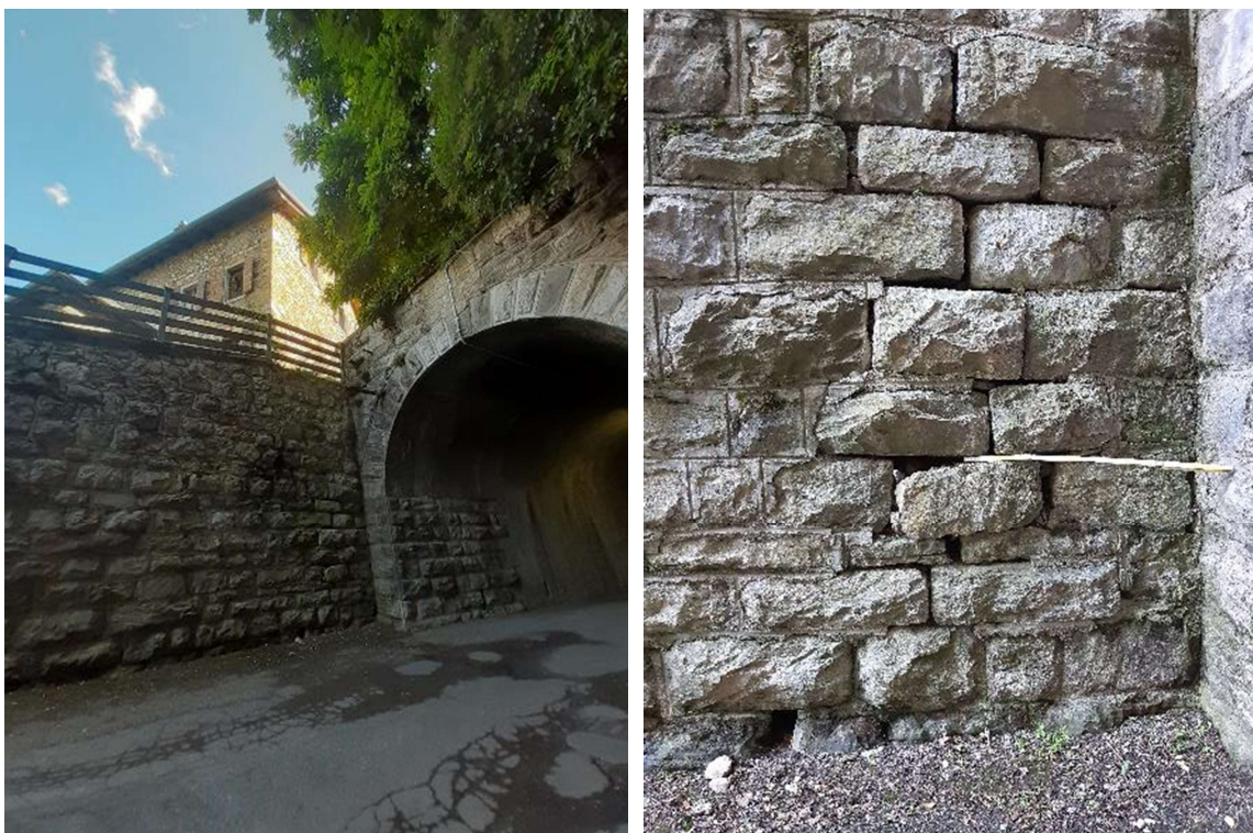
Figura 30 – Fotografia particolare – dissesto su muro di sostegno
