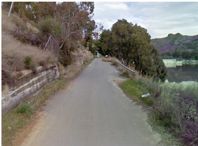
Figura 6 Esempio di criticità per la quale è previsto un intervento di Tipo 3 (fonte: Elaborato GEN0102RED “Relazione generale”, Aprile 2021)
