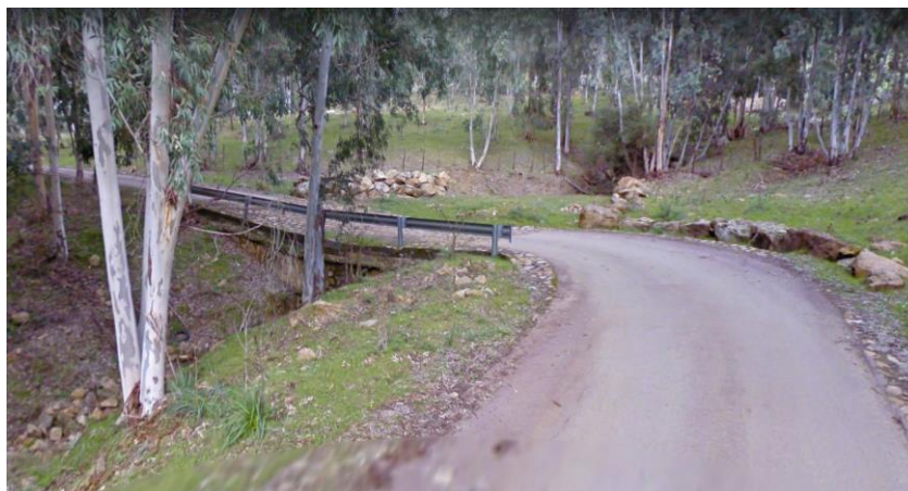
Figura 4 Esempio di criticità per la quale è previsto un intervento di Tipo 1 (fonte: Elaborato GEN0102RED “Relazione generale”, Aprile 2021)
