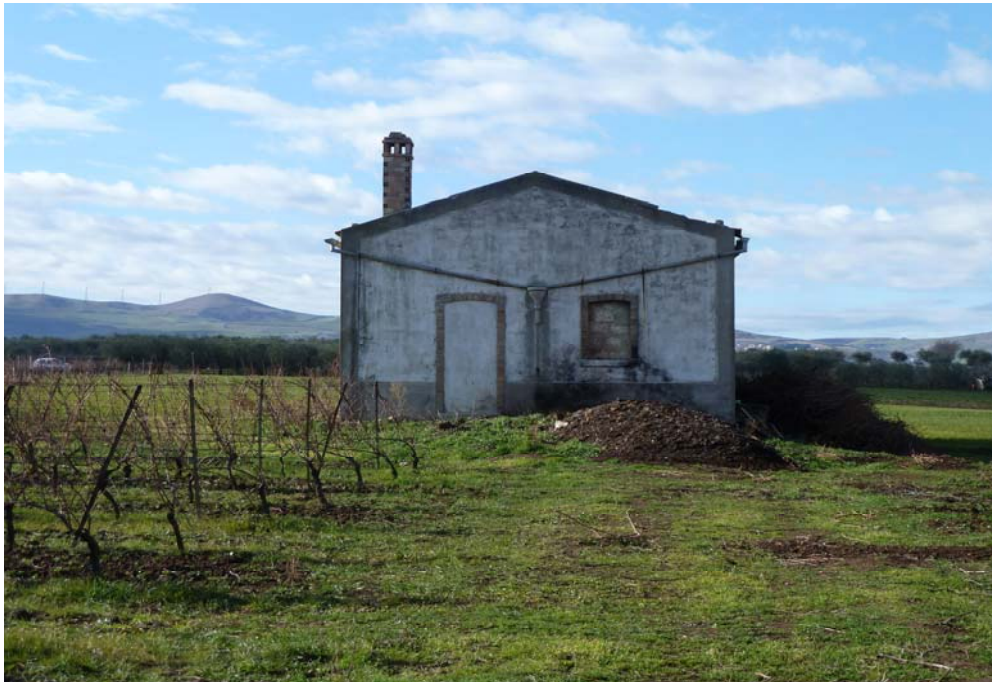
Figura 4 – Manufatto in stato di abbandono.
