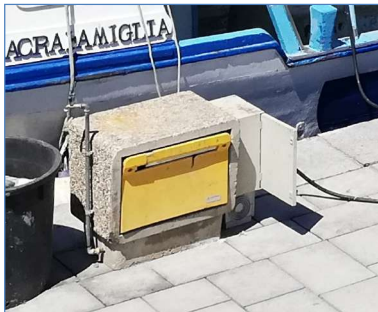
Figura 8- Colonnine di erogazione dei servizi sono obsolete e rotte.
