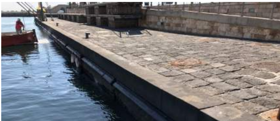
banchina del molo sottoflutto: interferenze con sotto servizi a rete (visibili i pozzetti)
