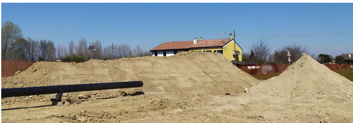
Fig. 8.2/C – Schemi generali di posa degli elementi fonoassorbenti: banchetta in terra battuta
