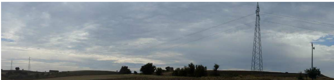
Figura 27: Panoramica linea elettrica esistente presso area SSE di Banzi –Vista verso sud-Est-ANTE OPERAM
