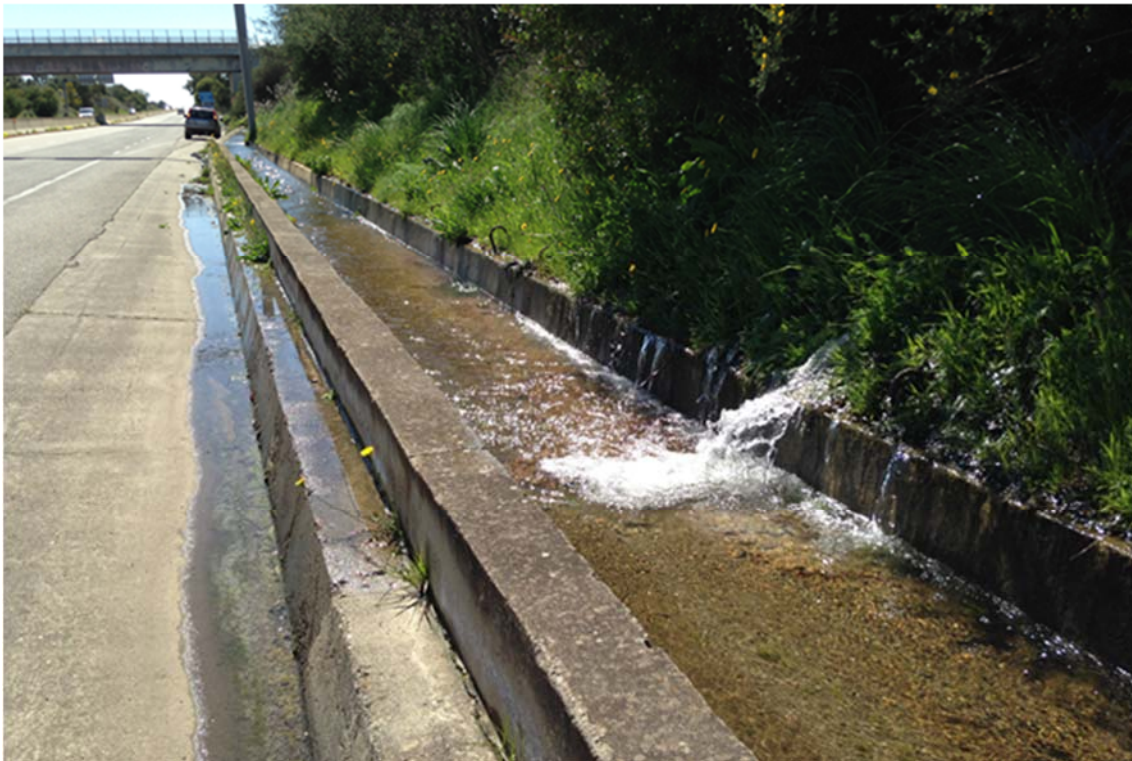
Foto 4 - Venute idriche lungo le scarpate antropiche nel Complesso alluvionale grossolano, all'altezza del km 22+500.
