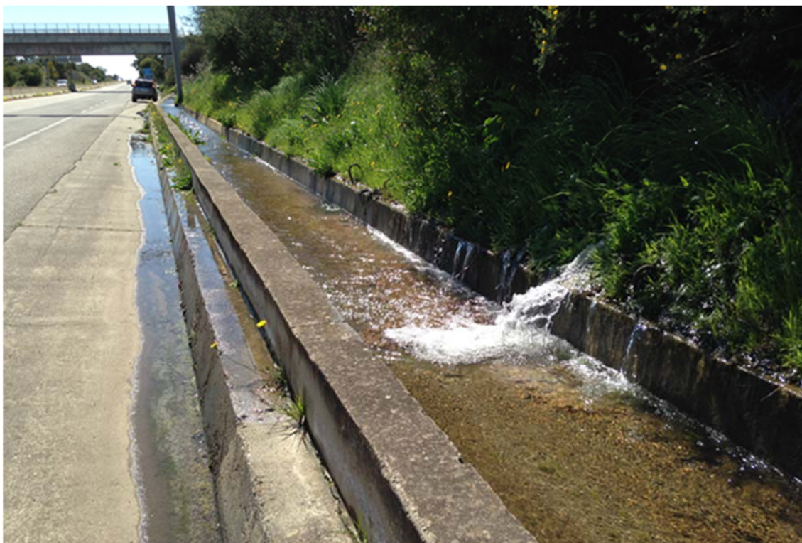
Foto 5 - Venute idriche lungo le scarpate antropiche nel Complesso alluvionale grossolano, all'altezza del km 22+500.
