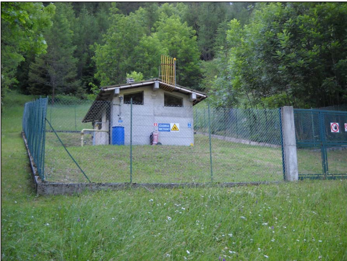
Fig. 21 Località Brendo – Cabina di prima riduzione e misura della Società ENEL S.p.a.
