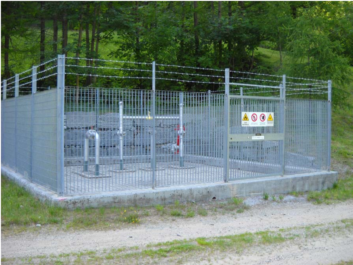
Fig. 20 Località Brendo – Stazione di controllo del metanodotto della Società SNAM S.p.a.
