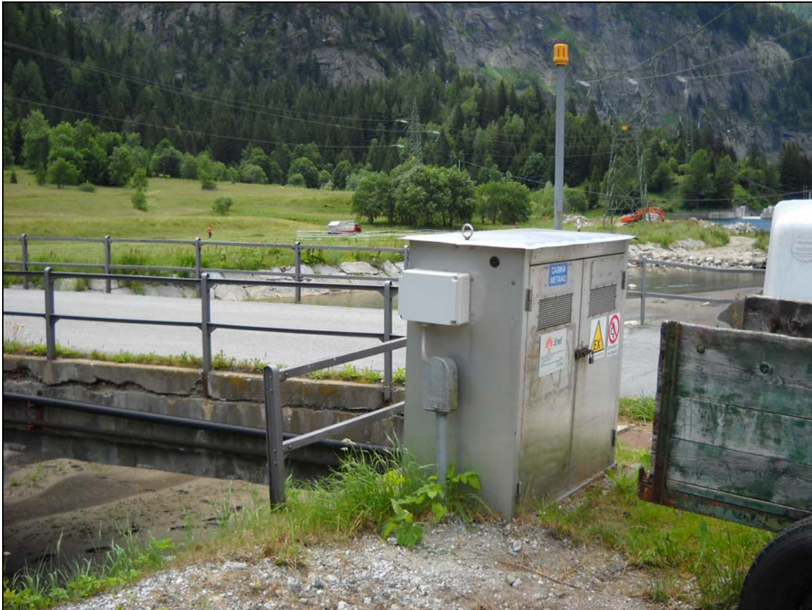
Fig. 24 Località Fondovalle – Cabina di riduzione della Società ENEL S.p.a. ubicata in prossimità del ponte sul Fiume Toce.
