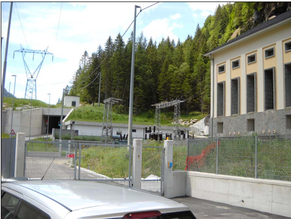
Fig. 13 S.E. di Fondovalle – Vista dell'ingresso carraio e del piazzale trasformatori.
