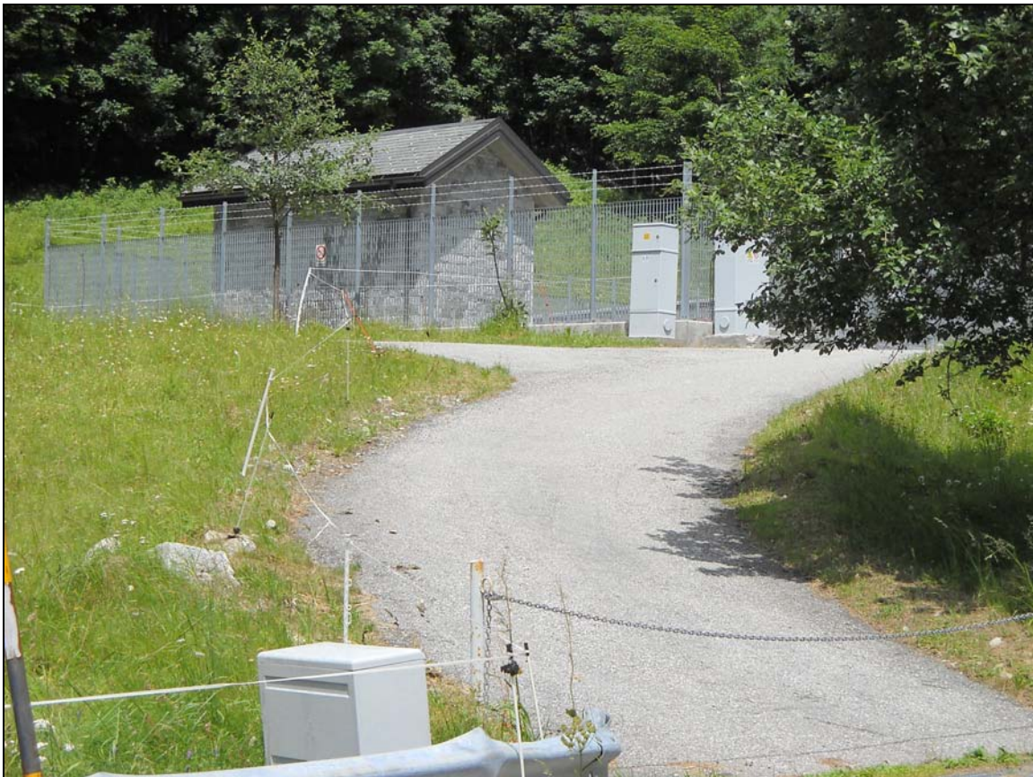
Fig. 25 Stazione della Società SNAM S.p.a. ubicata in prossimità della S.S. 659 nel tratto tra gli abitati di Fondovalle e Chiesa.
