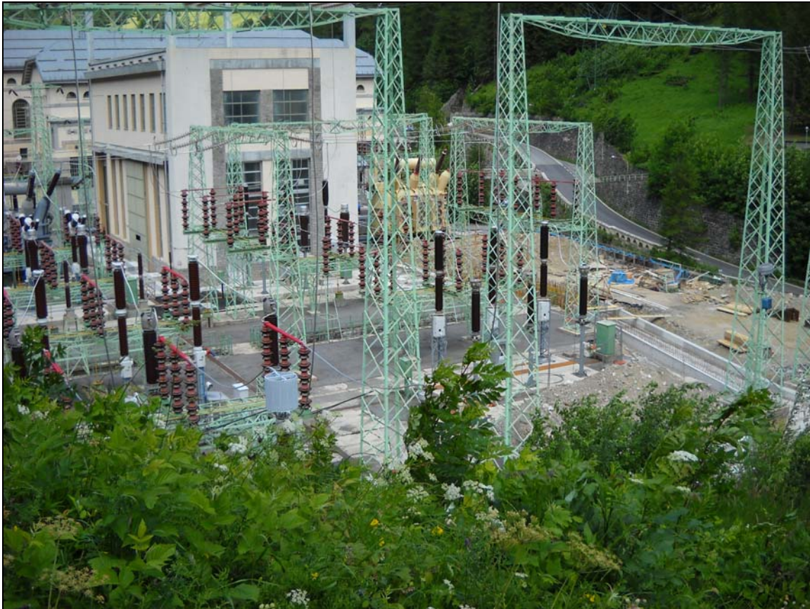
Fig. 8 S.E. di Ponte V.F. - Vista del piazzale di smistamento delle linee.
