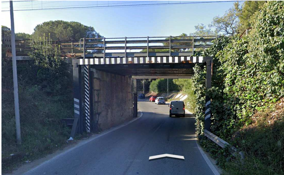
dir. SS7 (Via Appia), visuale dalla quale si evince lo stato di conservazione dell'attuale sottovia
