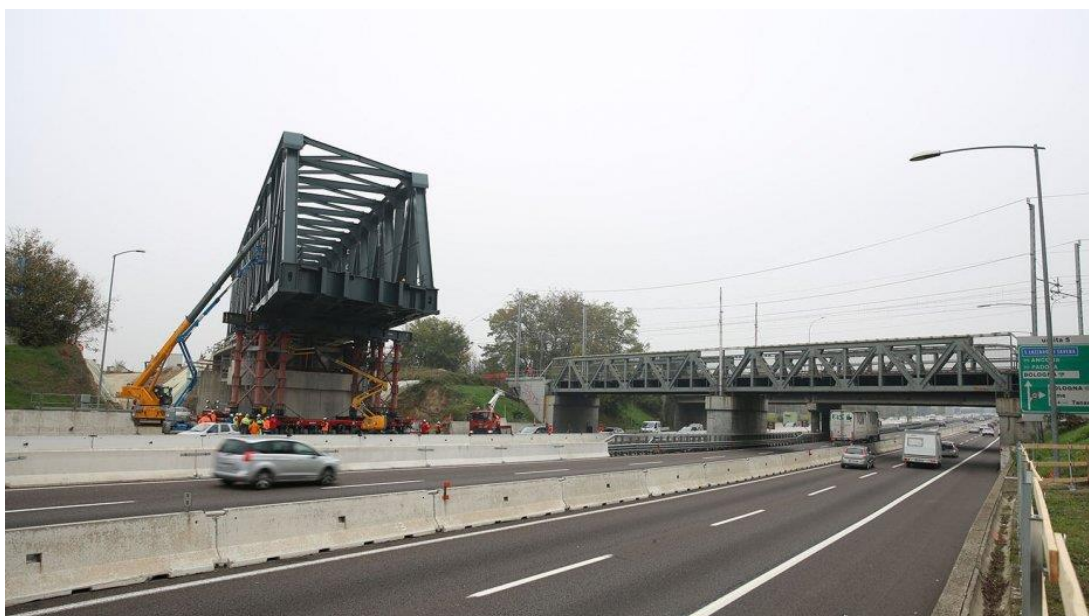
Esempio nuovo ponte linea AV sulla A14 e Tangenziale di Bologna (Fonte: Articolo web, 2015)
