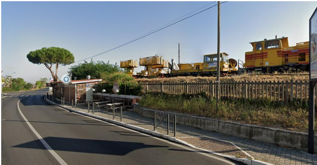
Foto punto di accesso da creare su via della Folgarella (fabbricato in demolizione)
