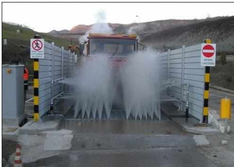
Figura 5 - Impianto lavaggio ruote
