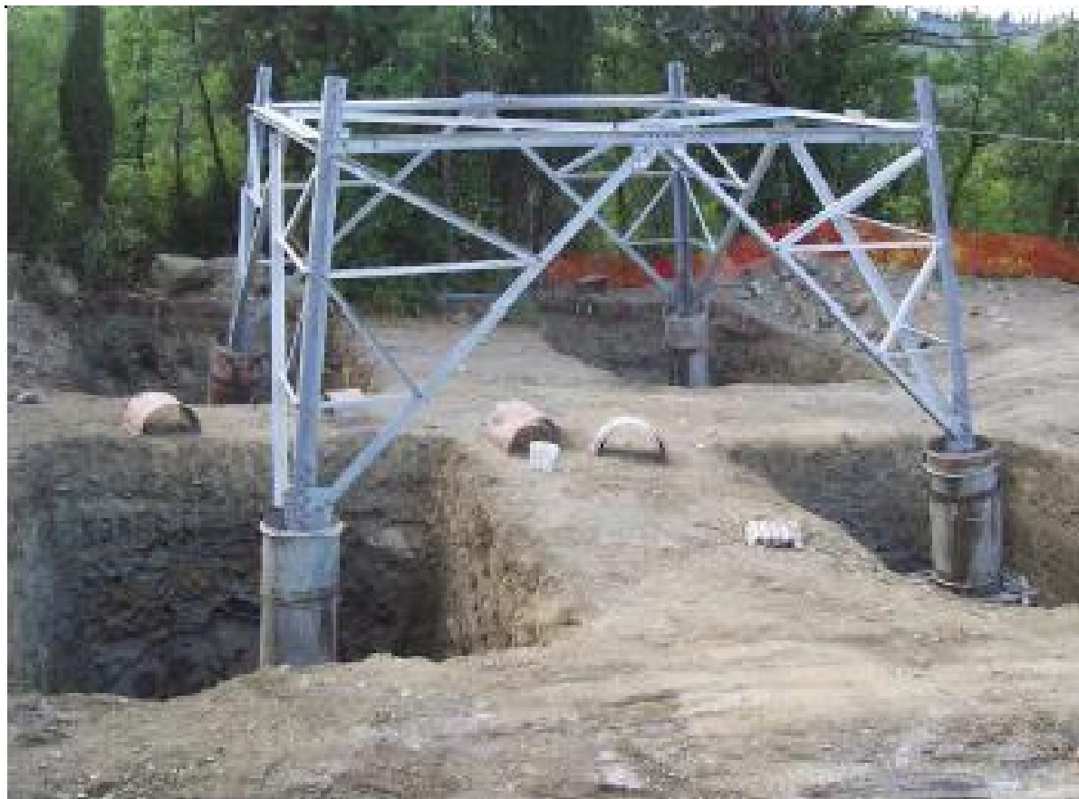
Figura 3-13: Realizzazione di fondazioni superficiali tipo CR per un sostegno a traliccio. Nell'immagine si possono osservare le quattro buche, la base del sostegno collegata alla fondazione tramite i "monconi" ed i casseri utilizzati per quattro "colonnini"
