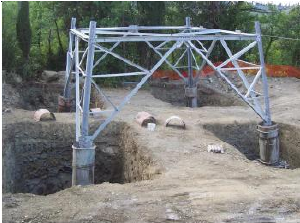
Figura 8-2 - Esempio di scavo per la realizzazione di fondazioni superficiali per un sostegno a traliccio. Si evidenziano le quattro buche, la base del sostegno collegata alla fondazione tramite i “monconi” ed i casseri utilizzati per quattro “colonnini”
