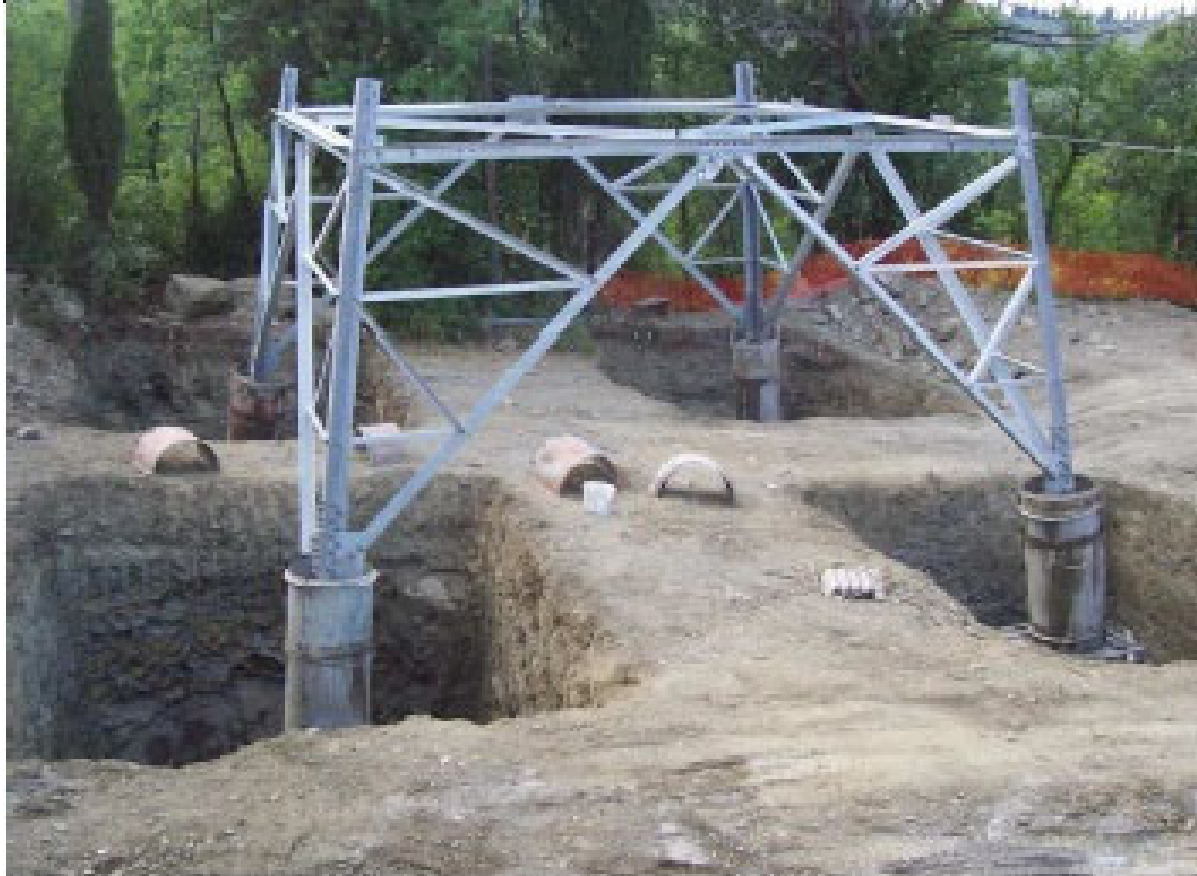
Figura 2-10: Realizzazione di fondazioni superficiali tipo CR per un sostegno a traliccio. Nell'immagine si possono osservare le quattro buche, la base del sostegno collegata alla fondazione tramite i "monconi" ed i casseri utilizzati per quattro "colonnini"
