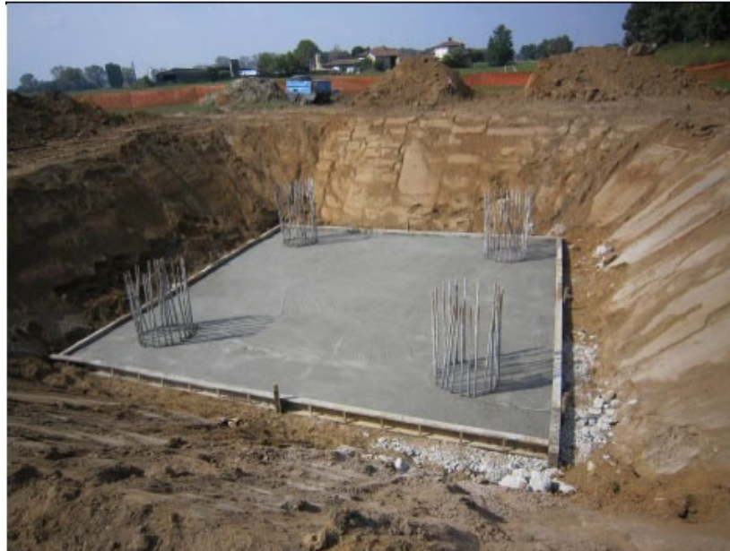
Figura 2-12: Realizzazione di una fondazione su pali trivellati per un sostegno monostelo. Nell'immagine si può osservare una fondazione in fase di realizzazione. Si possono distinguere facilmente i quattro pali trivellati già realizzati e gettati (si osservano le prese delle quattro gabbie metalliche) e del piano di magrone sul quale impostare il monoblocco in cls
