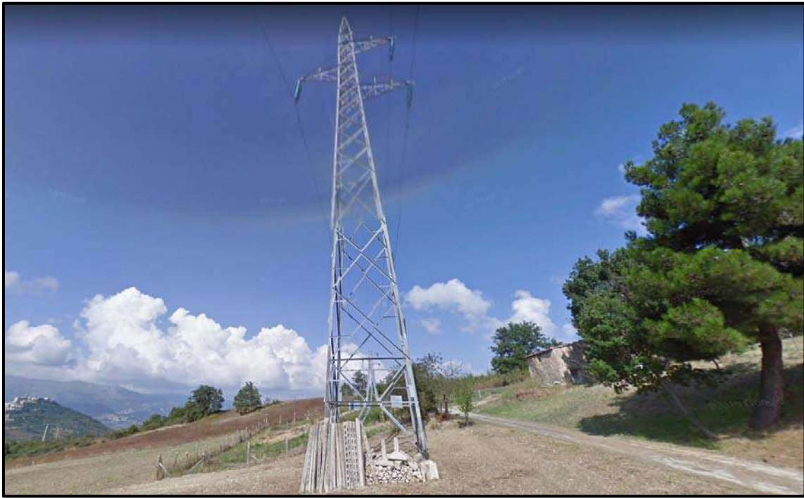
Fig. 8 – Traliccio n.7, lungo la Strada Comunale Colle Casale
