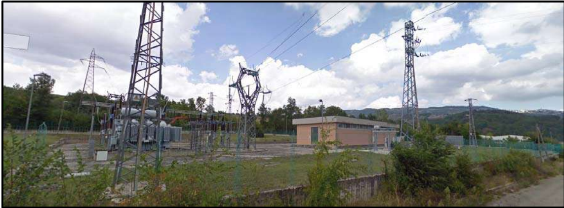
Fig. 6 – Panoramica della centrale elettrica di Carunchio.
