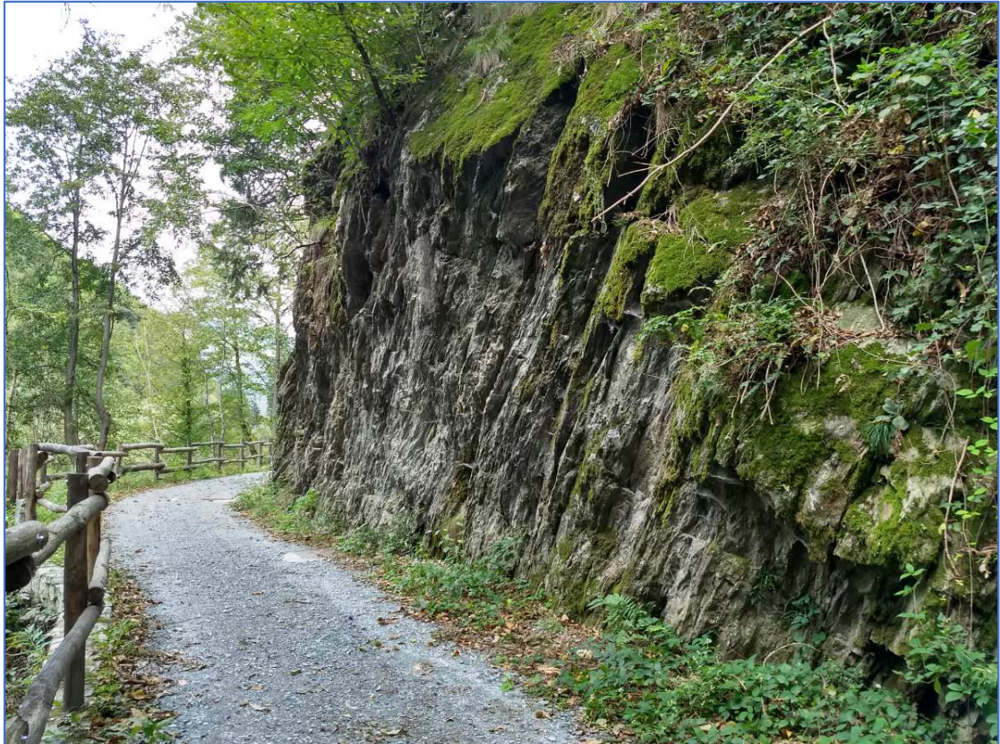
Figura 71 – Foliazione ad alto angolo che caratterizza l'ammasso nelle immediate vicinanze dell'imbocco N
