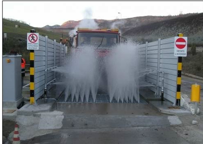
Impianto lavaggio ruote
