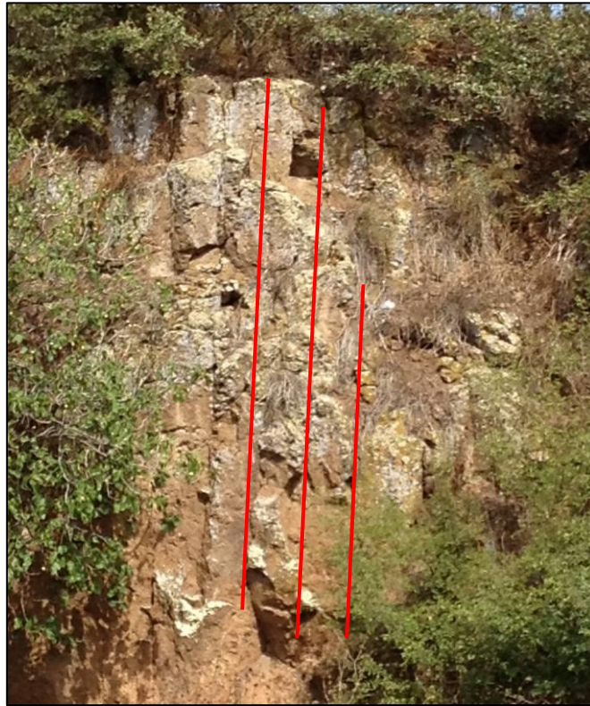
Figura 7 Affioramento di tufo, litoide, interessato da sistemi di fatturazione sub-verticali (in rosso)
