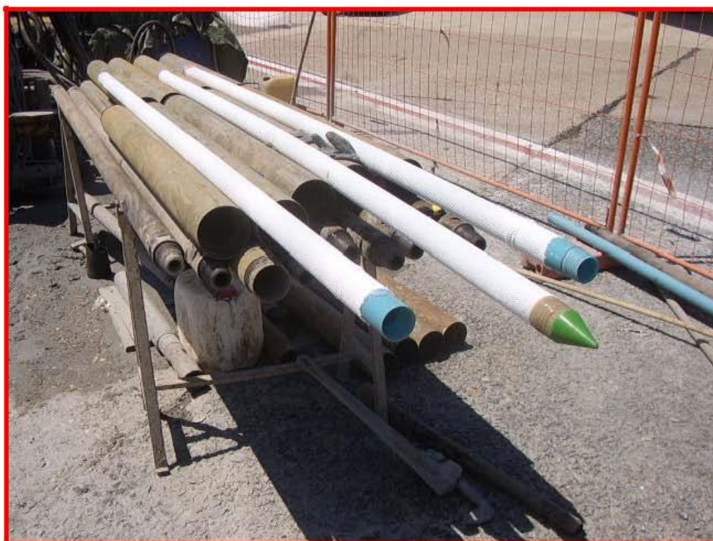
Tubazioni predisposte prima dell'installazione
