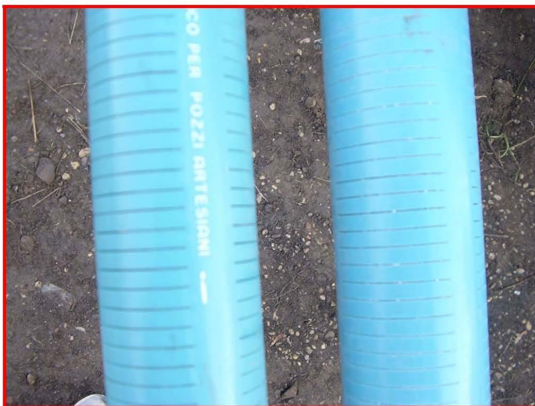
Particolare della tubazione piezometrica installata
