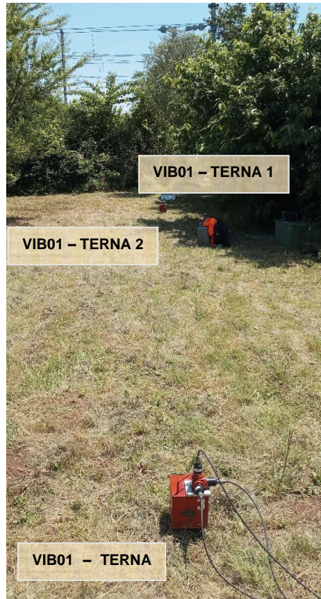
Figura 4-100 Foto di installazione
