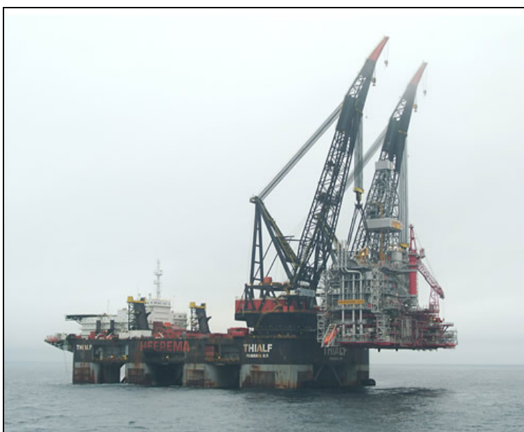
Figura B 11-2 Esempio di pontone impiegato per l'installazione di una ESP offshore
