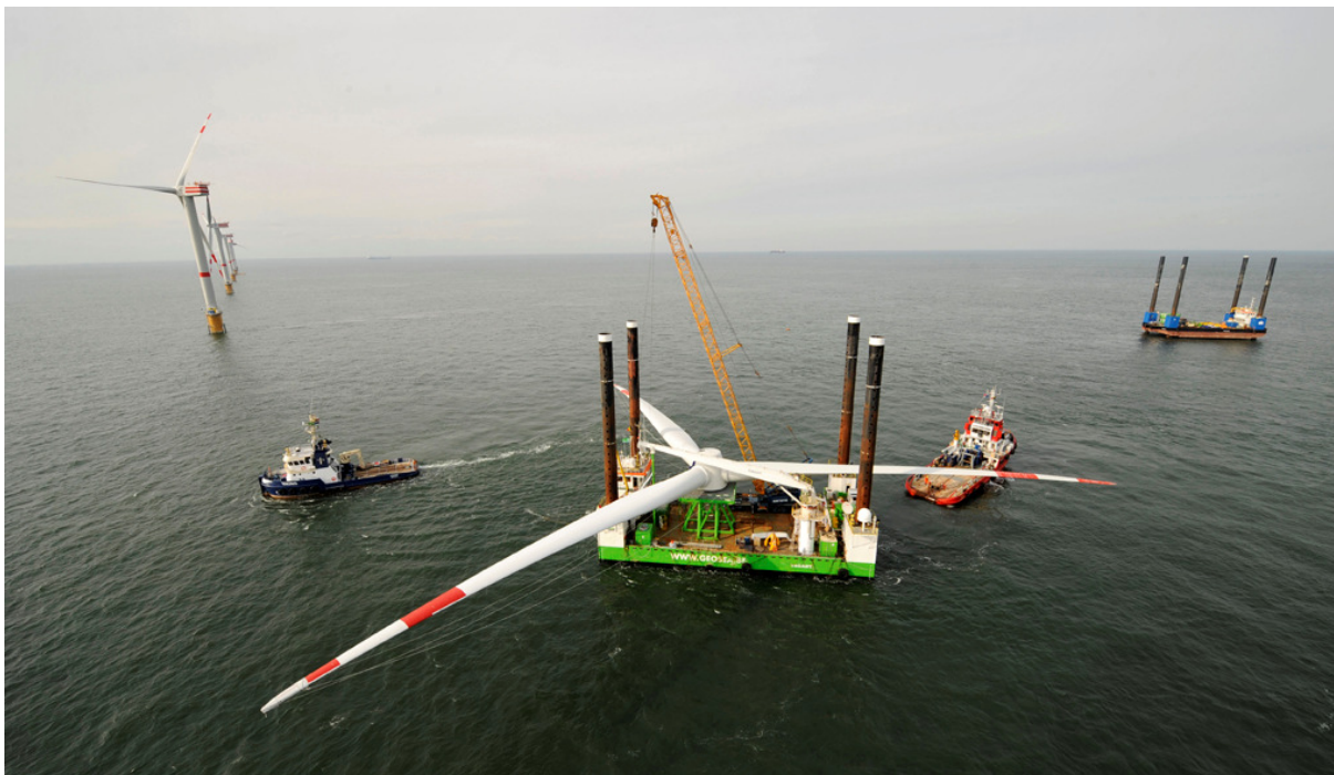
Figura B 7-4 Trasporto di rotore assemblato (D = 126 m) tramite chiatta - Thorntonbank wind farm [ http://www.repower.de ]
